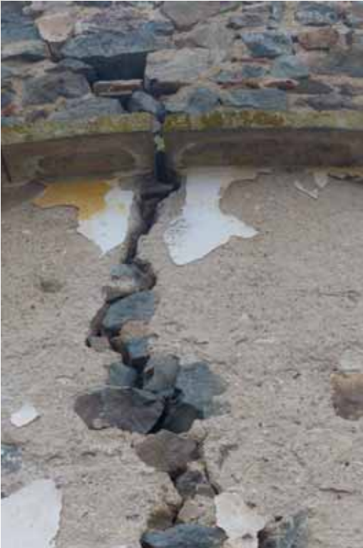
Document 23 : Ecartement du mur et de la bande anti-vermine au niveau de la fissure A.
