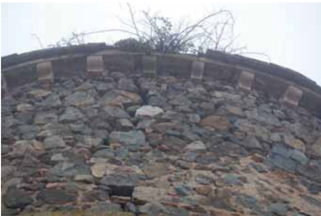
Document 20 : Tuiles manquantes et fissure A
