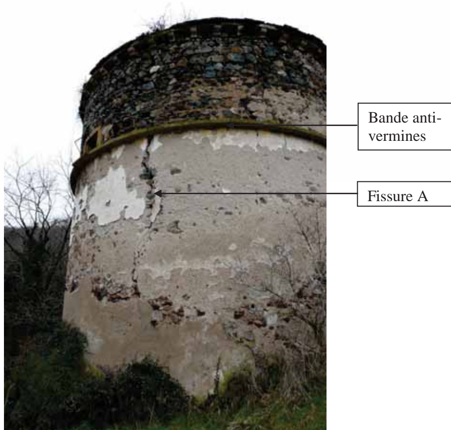
Document 34 : Détail fissure du Colombier de Suzy (Vue Est)
