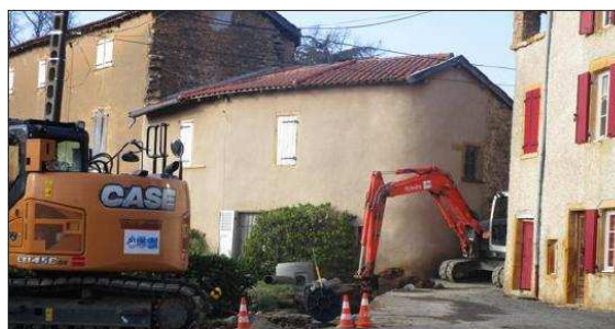
■ La voie communale 206 est barrée au niveau du lieu-dit la Chanaz. Photo Catherine LAPOSTOLET
