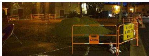
■ Les habitants sont invités à respecter les consignes de stationnement et de circulation durant les travaux. Photo SVM
